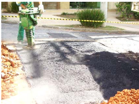
Figura 9 – Compactação da camada de Binder
