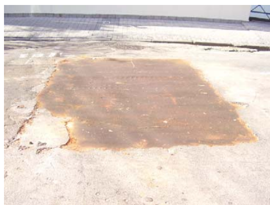
Figura 4 – Imperfeições no solo compactado
