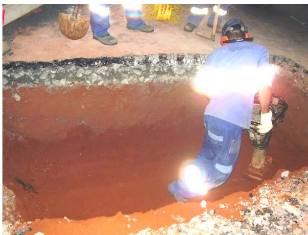
Figura 2 – Compactação do solo
